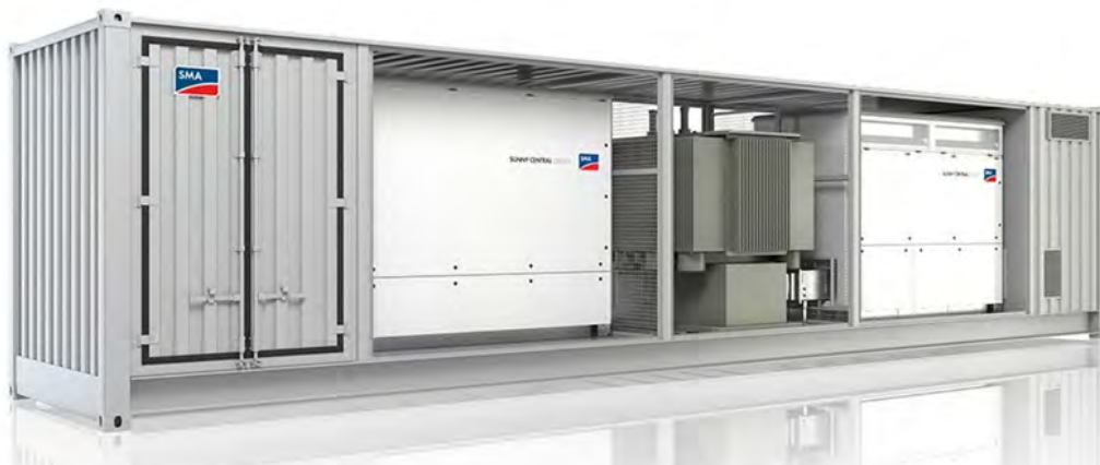
Figur 2.2: Eksempel på en centralinverter, som kombinerer invertere og fordelingstransformere i en samlet enhed.
